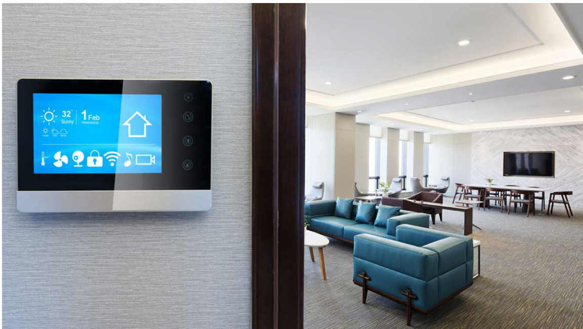
図 2. リビング ルームに設置された Bluetooth スマート サーモスタット
